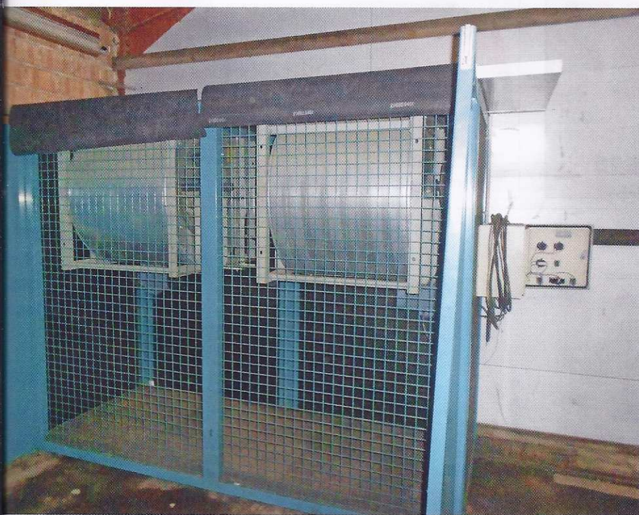
Foto 1: voorbeeld van een zuigwand voor twee rijen pallets. De lucht wordt door de pallets getrokken, waarbij de lucht steeds meer opwarmt.
