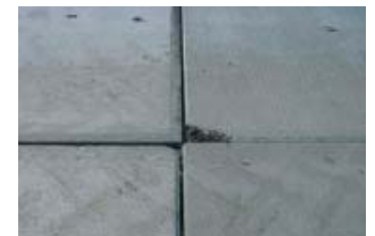
Foto 2: betonplaten met/zonder vellingkant, met/zonder staalband en wel/niet gebezemd
